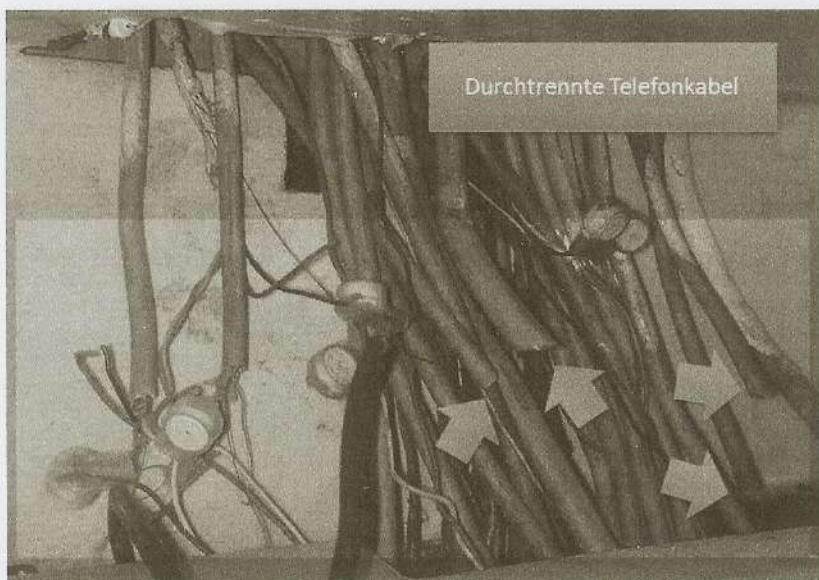
Foto Hausverteiler (sogenannter „APL“) 02. November 2017
